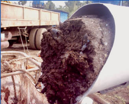
SOLIDOS FILTRADOS Y DESAGUADOS
